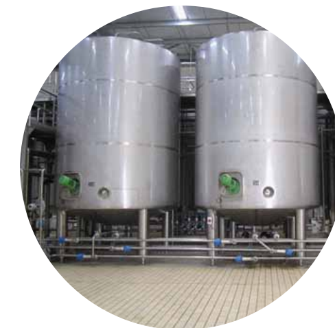
Khu Thanh trùng: Đã hoàn thành IO test, GEA triển khai chạy thử/ súc rửa hệ thống bằng nước.
