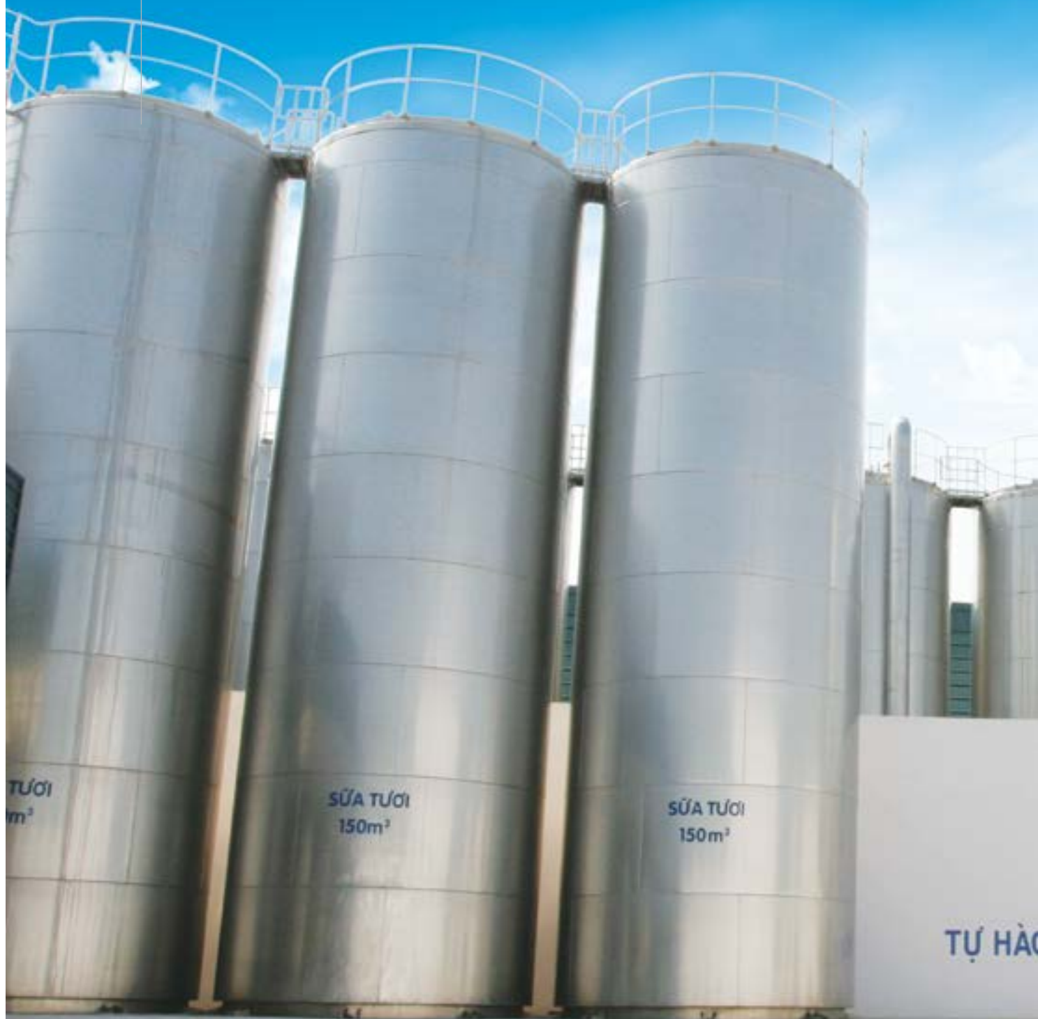
Hệ thống bốn chứa sữa nguyên liệu của “Siêu nhà máy” sữa nước
